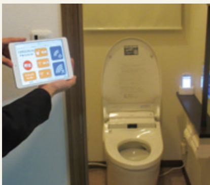
トイレ内に設置されたタブレット端末
